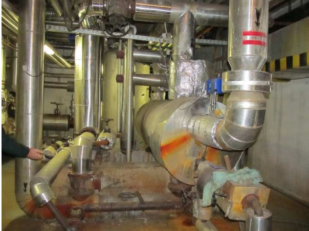
Pohled do výměňkové stanice
