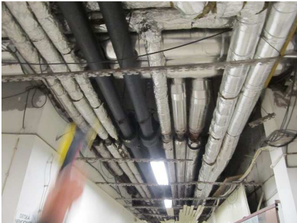
Rozvody ve spojovací chodbě
