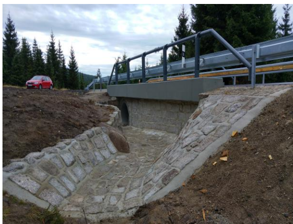
Silnice II/290 Smědava, havárie propustku
