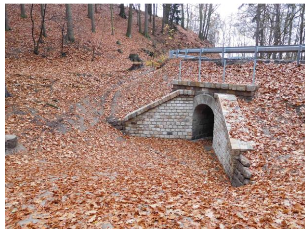
Silnice III/27921 Vyskeř - havárie propustku
