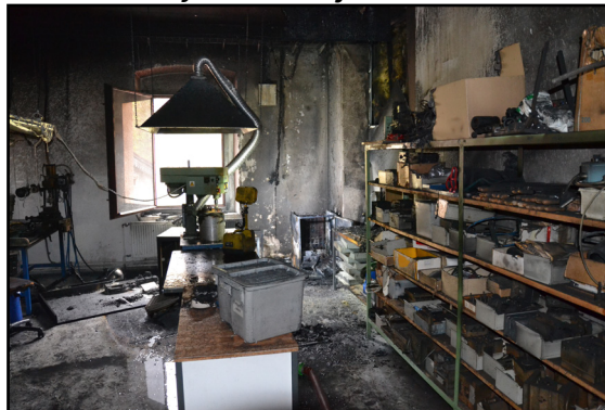
Požár výrobního objektu v Tanvaldu
