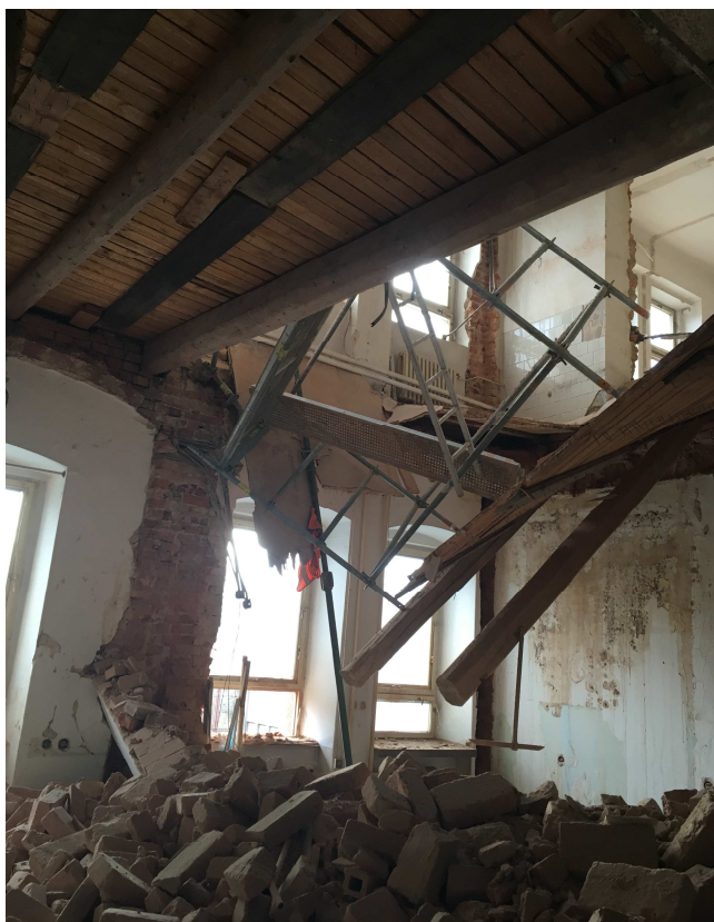
Pohled na havarovaný pilíř kolmý na fasádu – hladká styčná plocha bez vazby zdíva
